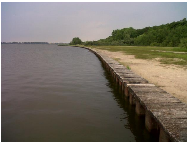
Bild 1: Zustand vor Bauausführung Marode Spundwand mit Abdeckung aus Lärchenholz
